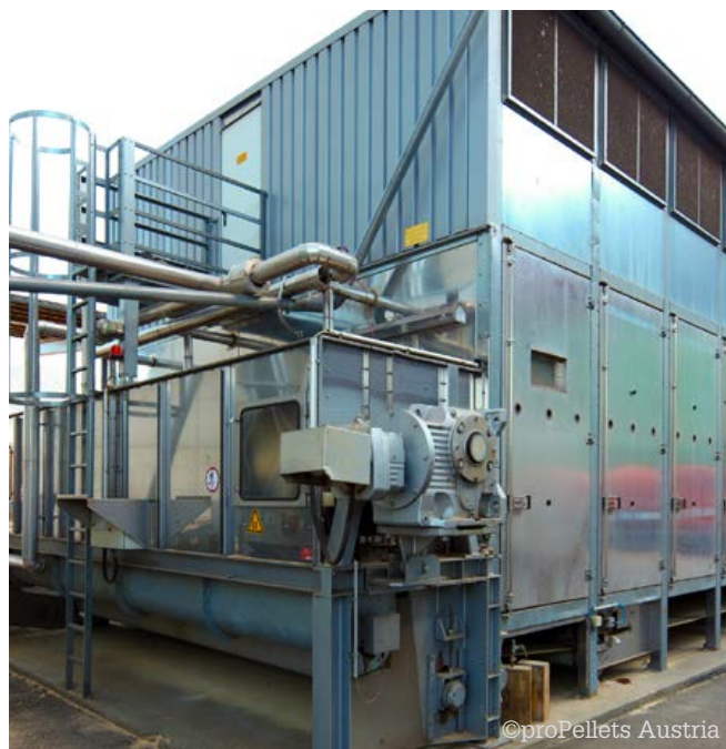
In solchen Anlagen werden die Holzspäne getrocknet, um dann zu Pellets weiterverarbeitet zu werden.
