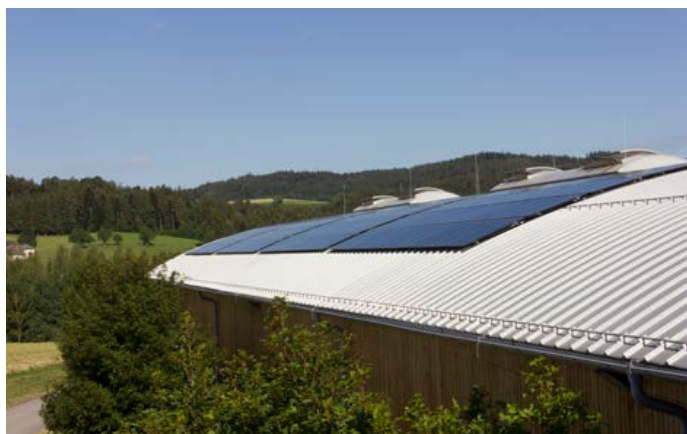
Die neue 70 kWp PV-Anlage am Hallendach in Niederkappel
