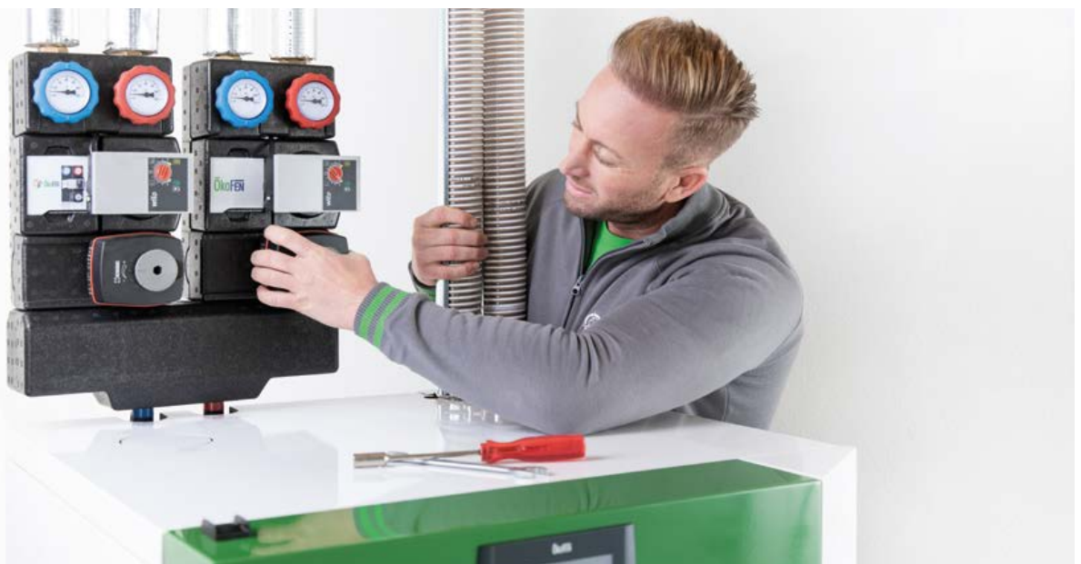
Die regelmäßige Wartung der Pelletsheizung gewährleistet einen optimalen Betrieb.
